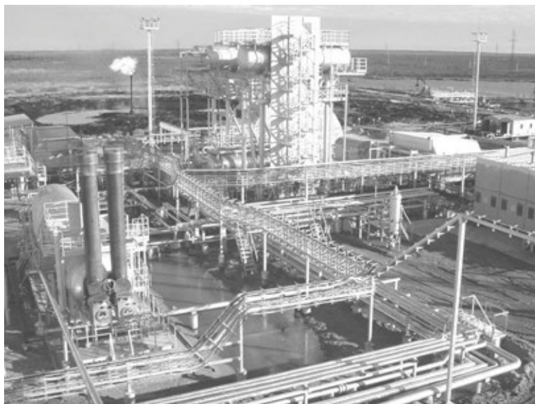
Дожимная насосная станция компании «ТНК»
