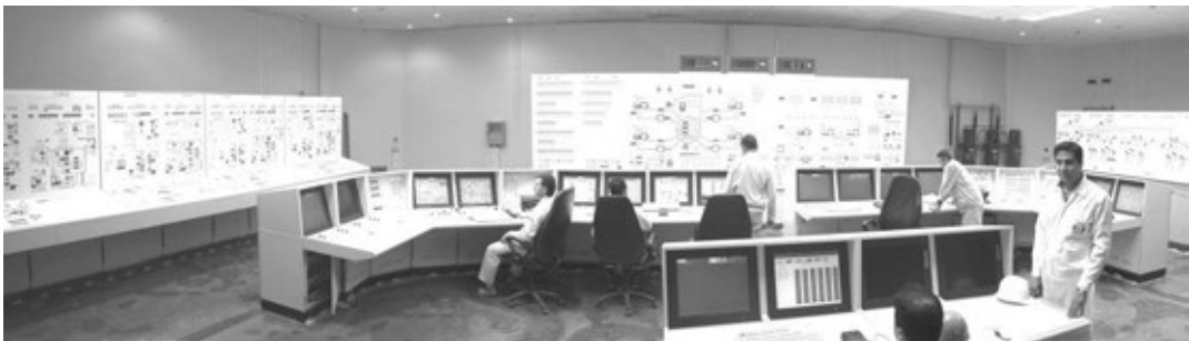
Блочный пульт управления АЭС с разработанной в Институте СВБУ
